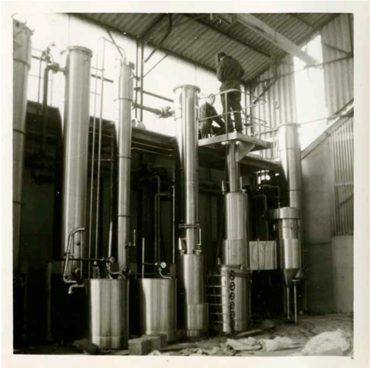
Photographie de chantier, mars 1963, construction du bâtiment pour la fabrication du lait concentré, installation des machines.- Photographie ancienne, de l'architecte Contamin, mars 1963. (Collection particulière Jean-Pierre Barette).
